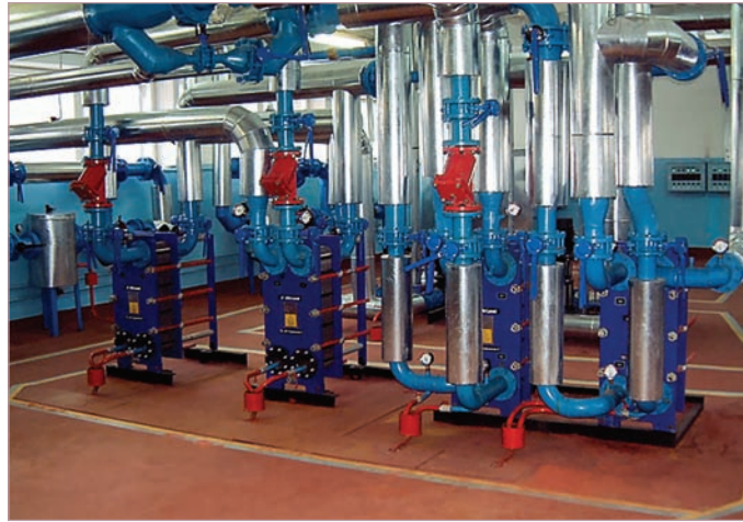
Модульний індивідуальний тепловий пункт
