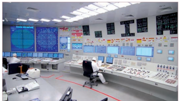
Центр керування АЕС. У розробці систем управління складними технологічними процесами брали участь вчені факультету автоматики та приладобудування
