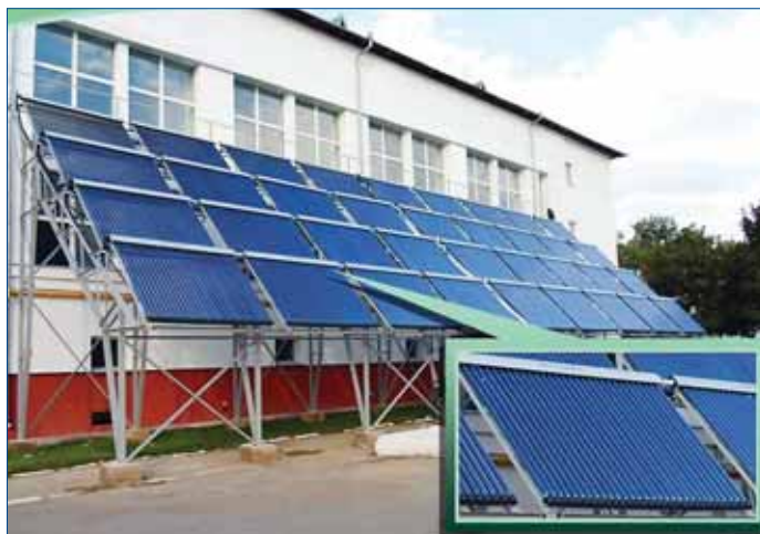
Сонячна теплова станція спорткомплексу
