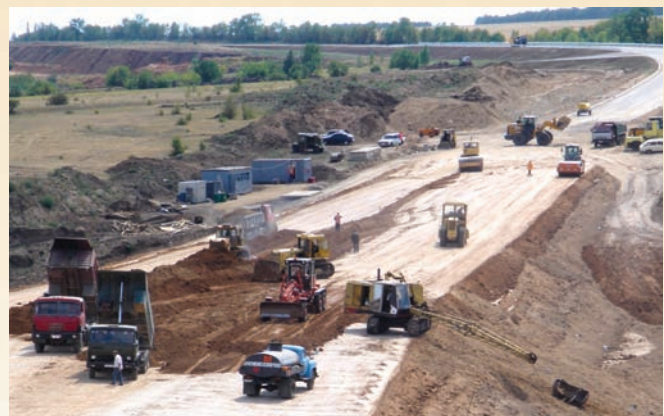
Спорудження металевої гофрованої труби та насипу на автомобільній дорозі Об'їзна, м. Бобринець
