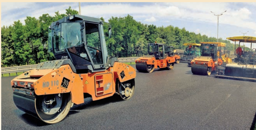
Влаштування верхнього шару покриття із щибенево-мастикового асфальтобетону. Автодорога Київ–Бориспіль, 19-й км, правий проїзд, червень 2004 р.
